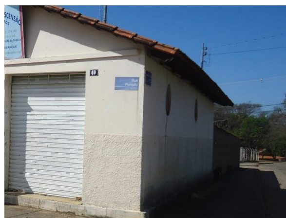
Pará de Minas Núcleo Histórico Urbano do Distrito de Ascensão Placas de logradouro na esquina da Rua Pompéu com a Avenida Presidente Kubitscheck apresentando leves desgastes.
