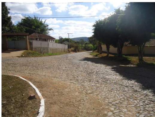
Pará de Minas Núcleo Histórico Urbano do Distrito de Ascensão Rua Raimundo Penaforte de Araújo exibindo com acúmulo de sujidades entre as pedras, no fundo, a via deixa de ser calçada e é em terra compactada.
