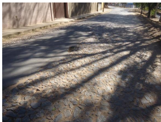
Pará de Minas Núcleo Histórico Urbano do Distrito de Ascensão Trecho da Avenida Presidente Kubitscheck exibindo remendos em alfalto sobre o pé de moleque.
