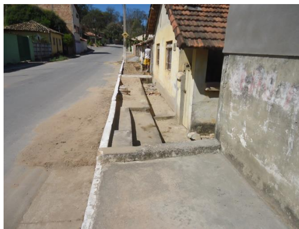
Pará de Minas Núcleo Histórico Urbano do Distrito de Carioca Sarjetas rasas da Rua Dona Maria Lopes Caçado apresentando grande acúmulo de areia. (foto 12)
