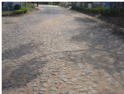
Pará de Minas Núcleo Histórico Urbano do Distrito de Ascensão Trecho da Rua Raimundo Penaforte de Araújo em pé de moleque, são notados trechos em a via recebeu reparos em alfalto.
