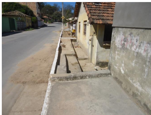
Pará de Minas Núcleo Histórico Urbano do Distrito de Carioca Degraus entres os diferentes níveis de uma calçada na Rua Dona Maria Lopes Cançado. (foto 18)
