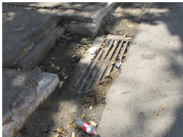
Pará de Minas Núcleo Histórico Urbano do Distrito de Carioca Detalhe de boca de lobo na Praça Nossa Senhora de Lourdes exibindo acúmulo de terra, areia, folhas e lixo. (foto 11)
