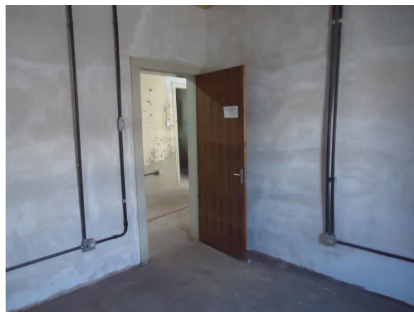
Pará de Minas Casa Maria Capanema As instalações elétricas foram refeitas em todos o bem. (foto 05)
