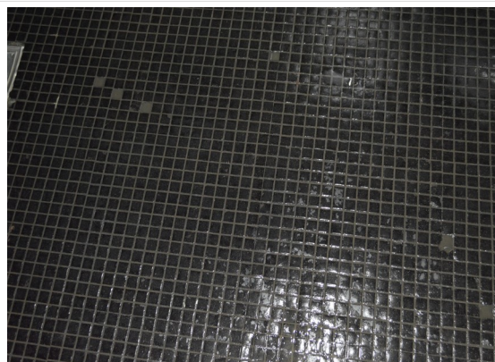
Pará de Minas Estação Ferroviária Pastilhas do banheiro PNE exibindo perda de algumas peças. (foto 46) Imagem: Júlia Gomes – 12/08/2021
