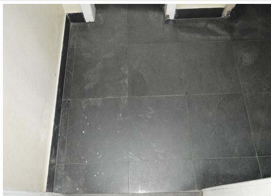
Pará de Minas Estação Ferroviária Cerâmicas dos banheiros do cinema bem conservadas apenas com sujidades. (foto 45) Imagem: Júlia Gomes – 12/08/2021
