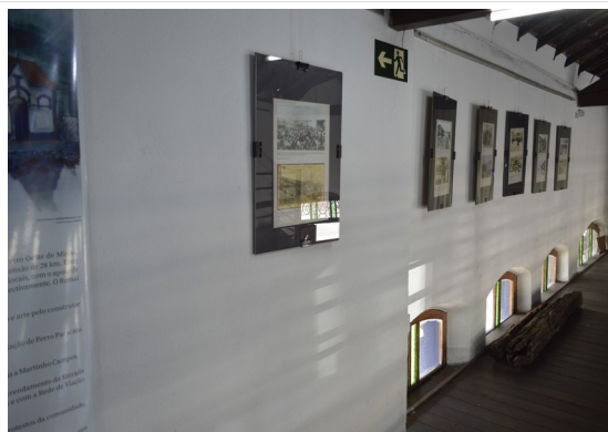
Pará de Minas Estação Ferroviária Reboco e pintura internos exibem ótimo estado. (foto 17) Imagem: Júllia Gomes – 12/08/2021
