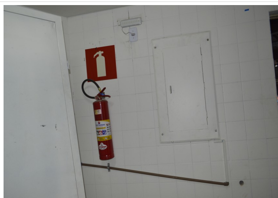
Pará de Minas Estação Ferroviária Revestimento cerâmico na copa exibe remendos feitos em cimento, todas as paredes receberam pintura em tinta epóxi para uniformizar. (foto 21) Imagem: Júllia Gomes – 12/08/2021
