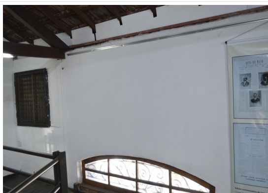
Pará de Minas Estação Ferroviária Detalhe da alvenaria interna. (foto 14) Imagem: Júlia Gomes – 12/08/2021
