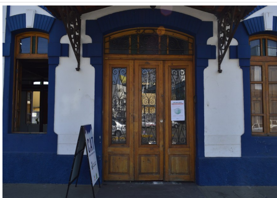
Pará de Minas Estação Ferroviária Porta de acesso principal exibindo algum desgaste na madeira porém no geral aparenta bom estado de conservação. (foto 25) Imagem: Júllia Gomes – 12/08/2021
