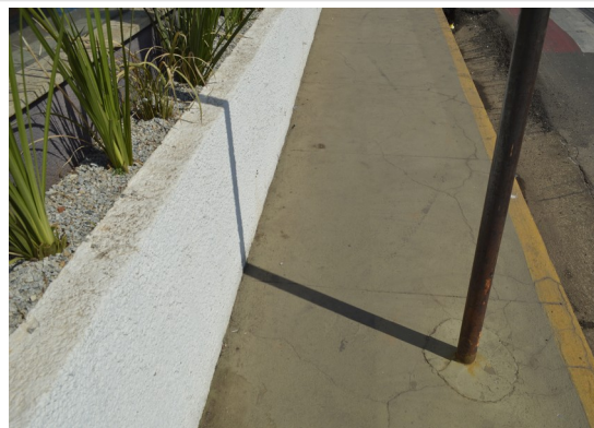
Pará de Minas Estação Ferroviária Passeio na fachada posterior da edificação apresenta sujidades naturais do uso. (foto 60) Imagem: Júllia Gomes – 12/08/2021
