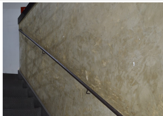
Pará de Minas Estação Ferroviária Parede com textura de cimento queimado junto à escada de acesso ao mezanino exhibe alguns riscos e manchas. (foto 18) Imagem: Júllia Gomes – 12/08/2021
