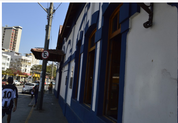
Pará de Minas Estação Ferroviária Fachada frontal sem aparentar danos estruturais. (foto 05) Imagem: Júllia Gomes – 12/08/2021
