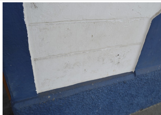
Pará de Minas Estação Ferroviária Detalhe das sujidades na fachada frontal. (foto 16) Imagem: Júllia Gomes – 12/08/2021
