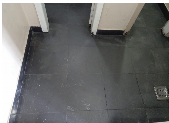
Pará de Minas Estação Ferroviária Piso em granito dos banheiros do mezanino com sujidades pois encontram – se isolados. (foto 47) Imagem: Júlia Gomes – 12/08/2021
