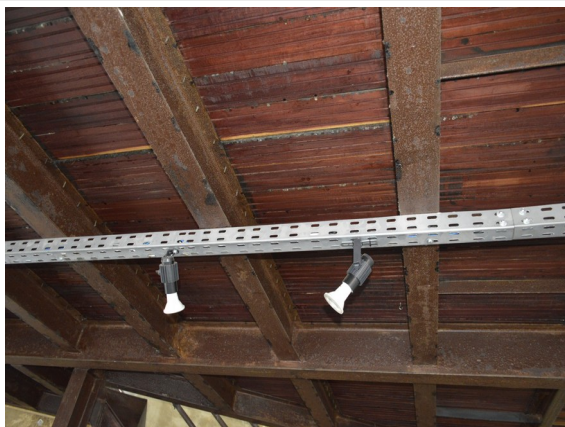
Pará de Minas Estação Ferroviária Iluminação direcionável feita através de eletrocalhas. (foto 63) Imagem: Júllia Gomes – 12/08/2021
