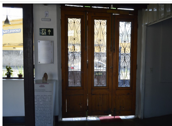
Pará de Minas Estação Ferroviária Porta de madeira que dá acesso à varanda exibindo remendos no material anteriormente degradado. (foto 26) Imagem: Júllia Gomes – 12/08/2021
