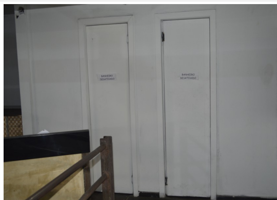
Pará de Minas Estação Ferroviária Portas dos banheiros do mezanino feitas em madeira e com enquadramento também em madeira em bom estado apenas com algumas sujidades na pintura na borda inferior. (foto 36) Imagem: Júllia Gomes – 12/08/2021
