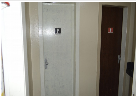
Pará de Minas Estação Ferroviária Portas dos banheiros do cinema que não tiveram pintura concluída. (foto 35) Imagem: Júllia Gomes – 12/08/2021
