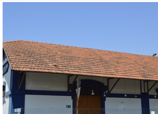
Pará de Minas Estação Ferroviária Telhas francesas exibem manchas causadas pela umidade. (foto 08) Imagem: Júllia Gomes – 12/08/2021
