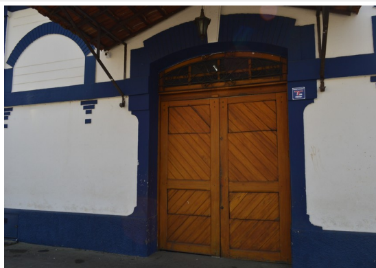
Pará de Minas Estação Ferroviária Porta de madeira ao lado esquerdo na fachada frontal exibe recortes nas folhas executados anteriormente a retomada do bem pelo município. (foto 27) Imagem: Júllia Gomes – 12/08/2021
