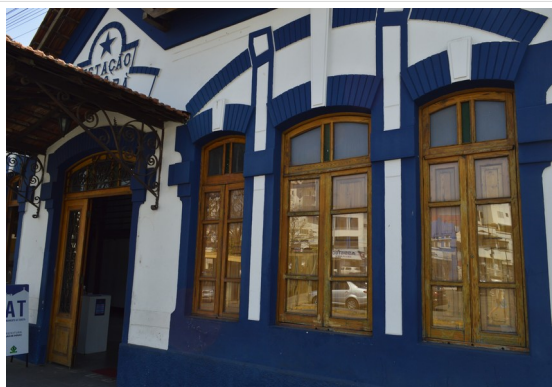
Pará de Minas Estação Ferroviária Janelas da fachada frontal da Estação em madeira e vidro, enquadramento em massa sobreverga e elementos artísticos em bom estado. (foto 29) Imagem: Júllia Gomes – 12/08/2021
