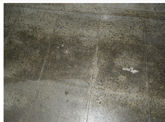
Pará de Minas Estação Ferroviária Piso em granito na cozinha apresenta manchas de gordura absorvida pelo material devido ao antigo uso do edifício. (foto 48) Imagem: Júlia Gomes – 12/08/2021
