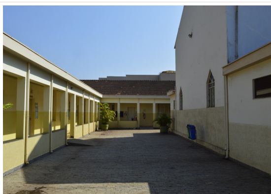
Pará de Minas Asilo Padre José Pereira Coelho Fachada posterior exibindo reboco e pintura em bom estado. (foto 13)
