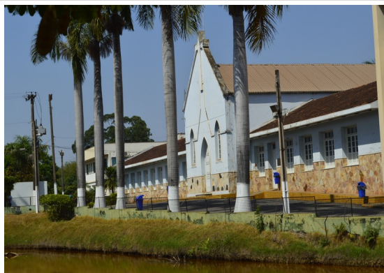
Pará de Minas Asilo Padre José Pereira Coelho Lagoa e jardins em frente à fachada frontal exibem boa manutenção de seus elementos. (foto 50) Imagem: Júllia Gomes– 01/10/2021
