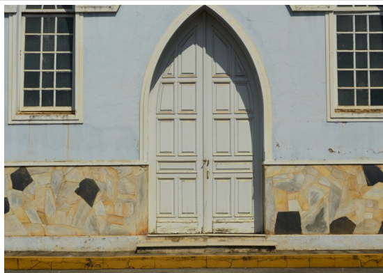
Pará de Minas Asilo Padre José Pereira Coelho Porta em madeira de acesso à Capela, exibindo leve desgaste na base. (foto 20) Imagem: Júllia Gomes– 01/10/2021
