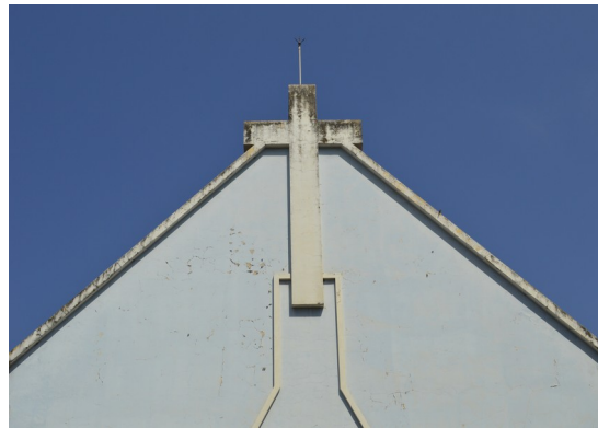
Pará de Minas Asilo Padre José Pereira Coelho Frontão e cimalha simples bem conservados. (foto 08) Imagem: Júllia Gomes– 01/10/2021
