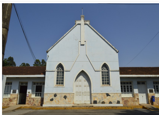
Pará de Minas Asilo Padre José Pereira Coelho Pintura da fachada frontal necessitando de renovação. (foto 14)
