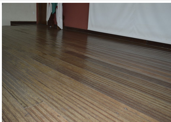
Pará de Minas Asilo Padre José Pereira Coelho Piso em madeira do palco do auditório apresentando algum desgaste pelo uso. (foto 34) Imagem: Júllia Gomes– 01/10/2021
