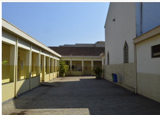
Pará de Minas Asilo Padre José Pereira Coelho A estrutura em vigas e pilares de concreto armado não apresenta danos. (foto 05) Imagem: Júllia Gomes– 01/10/2021
