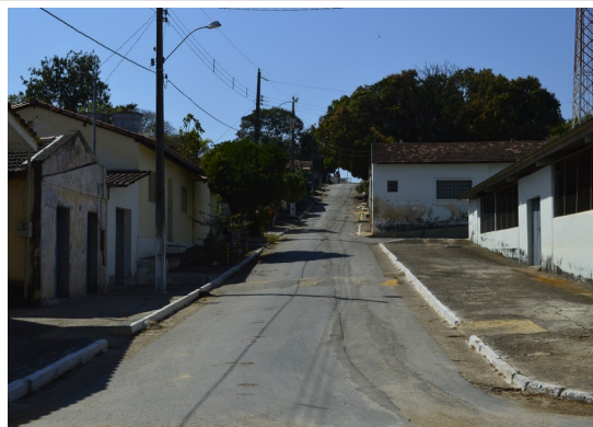
Pará de Minas Núcleo Histórico Urbano do Distrito de Carioca Vista da Rua N. Sra. Aparecida exibindo remendos no asfalto e um pouco de perda de material. (foto 05) Imagem: Júllia Gomes – 18/08/2021
