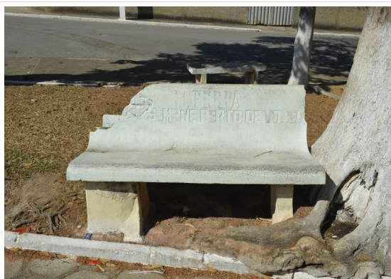
Pará de Minas Núcleo Histórico Urbano do Distrito de Carioca Banco em concreto com perda de material. (foto 71) Imagem: Júllia Gomes – 18/08/2021
