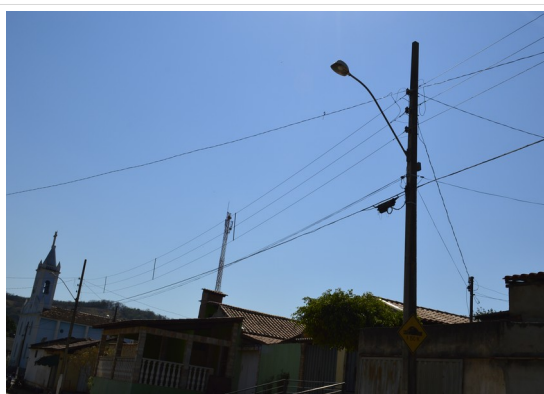
Pará de Minas Praça de Nossa Senhora de Lourdes Fiação aparente na Rua Nossa Senhora da Piedade. (foto 36) Imagem: Júllia Gomes – 18/08/2021
