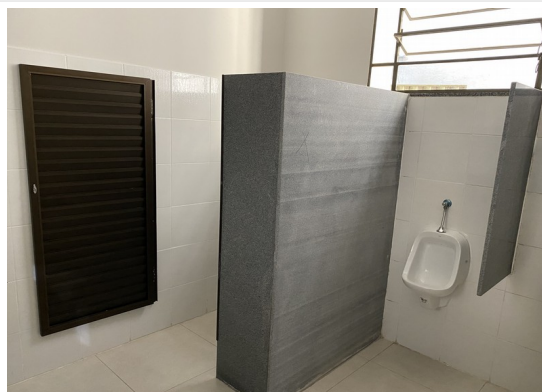
Pará de Minas Centro Literário Pedro Nestor Cerâmicas de um dos banheiros. (foto 14) Imagem: Júllia Gomes – 24/09/2021
