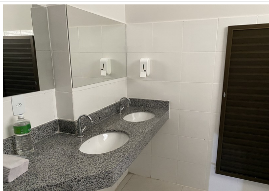
Pará de Minas Centro Literário Pedro Nestor Instalações hidráulicas em funcionamento . (foto 34) Imagem: Júllia Gomes – 24/09/2021
