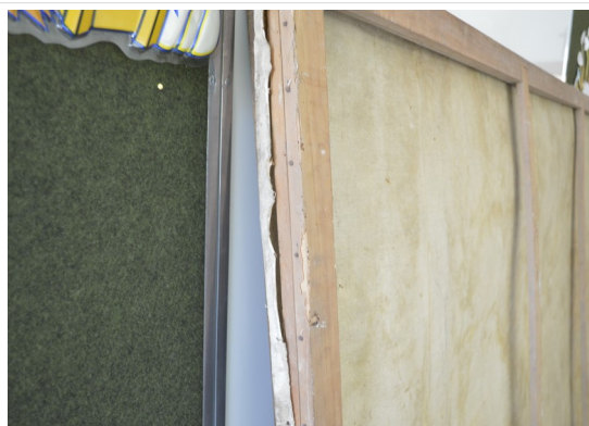
Pará de Minas Telas da Antiga Matriz de Nossa Senhora da Piedade Craquelês, desprendimento de camada Pictórica, descolamento da tela no chassi e perda de material.
