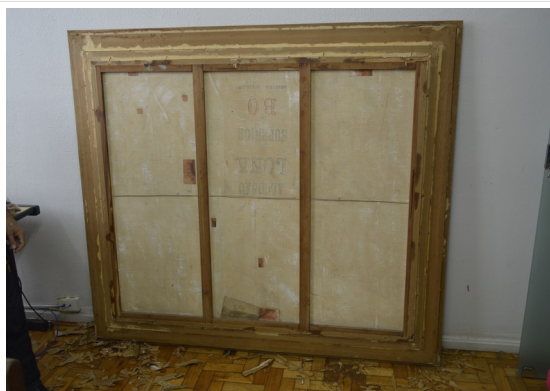
Pará de Minas Telas da Antiga Matriz de Nossa Senhora da Piedade Vista posterior da Nossa Senhora da Piedade, apresenta estado regular de conservação. (foto 15) Imagem: Júllia Gomes – 20/08/2021
