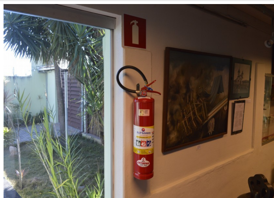
Pará de Minas Telas da Antiga Matriz de Nossa Senhora da Piedade Instalações de combate a incêndio no interior do MUSPAM. (foto 54) Imagem: Júllia Gomes – 20/08/2021
