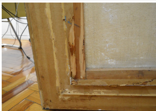
Pará de Minas Telas da Antiga Matriz de Nossa Senhora da Piedade Chassi sob ataque de insetos xilófagos, especialmente em suas porções inferiores. (foto 35) Imagem: Júllia Gomes – 01/10/2021
