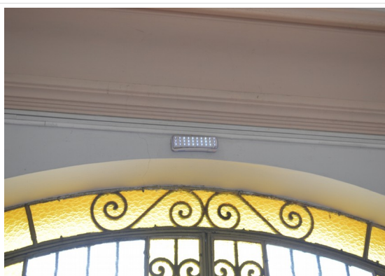
Pará de Minas Escola Estadual Fernando Otávio Iluminação de emergência. (foto 51) Imagem: Júllia Gomes – 30/08/2021
