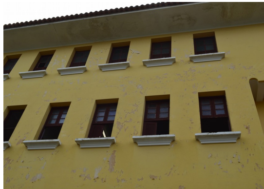
Pará de Minas Escola Estadual Fernando Otávio Janelas em madeira e vidro que compõem as fachadas. (foto 22) Imagem: Júllia Gomes – 30/08/2021
