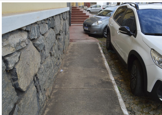
Pará de Minas Escola Estadual Fernando Otávio Cimentado nas calçadas. (foto 29) Imagem: Júllia Gomes – 30/08/2021
