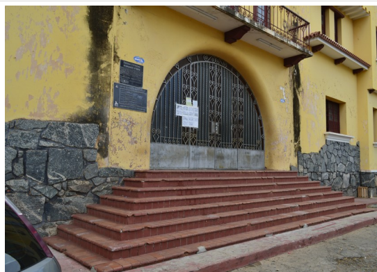
Pará de Minas Escola Estadual Fernando Otávio Escada da entrada principal revestida em cerâmica. (foto 30) Imagem: Júllia Gomes – 30/08/2021
