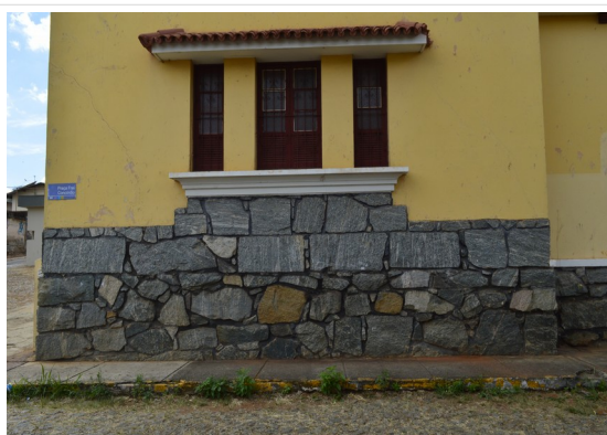
Pará de Minas Escola Estadual Fernando Otávio barrado em pedras marcam o baldrame na fachada. (foto 15) Imagem: Júllia Gomes – 30/08/2021
