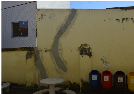
Pará de Minas Escola Estadual Governador Valadares Muro lateral direito exibindo trinca restaurada decorrente de abalo provocado pela construção vizinha. (foto 44) Imagem: Júllia Gomes– 02/09/2021
