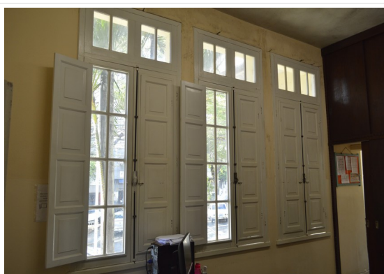
Pará de Minas Escola Estadual Governador Valadares Vista interna janela da fachada frontal em madeira. (foto 22) Imagem: Júllia Gomes– 02/09/2021
