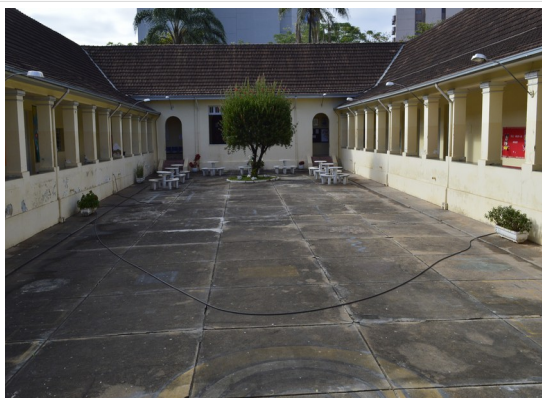
Pará de Minas Escola Estadual Governador Valadares Piso cimentado no pátio interno. (foto 27) Imagem: Júllia Gomes– 02/09/2021
