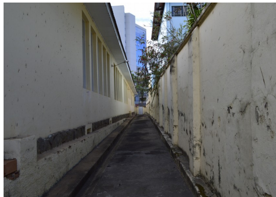
Pará de Minas Escola Estadual Governador Valadares Muro lateral esquerdo. (foto 45) Imagem: Júllia Gomes– 02/09/2021
