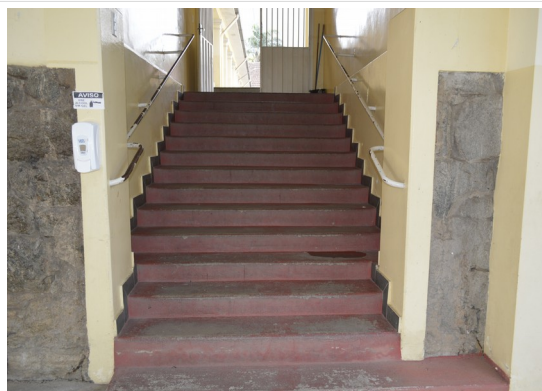
Pará de Minas Escola Estadual Governador Valadares J Cimento vermelho na escada entre de acesso ao refeitório. (foto 28) Imagem: Júllia Gomes– 02/09/2021
