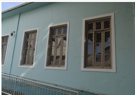
Pará de Minas Escola Estadual Torquato de Almeida Janela em madeira e vidro e grade em metal das fachadas laterais. (foto 22) Imagem: Júllia Gomes – 13/09/2021
