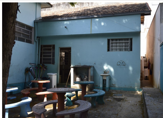
Pará de Minas Escola Estadual Torquato de Almeida Janelas em metal e vidro e enquadramento em massa na cozinha. (foto 21) Imagem: Júllia Gomes – 13/09/2021
