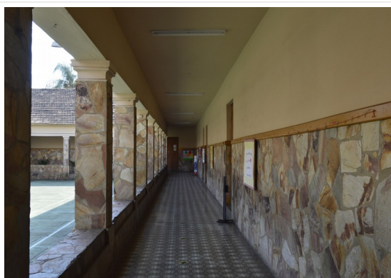
Pará de Minas Escola Estadual Torquato de Almeida Pintura a base de água nas alvenarias e na laje. (foto 13) Imagem: Júlia Gomes – 13/09/2021
