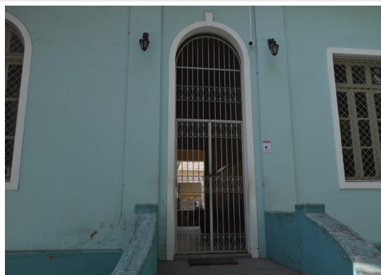
Pará de Minas Escola Estadual Torquato de Almeida Portão gradeado em metal nas laterais do bem. (foto 19) Imagem: Júllia Gomes – 13/09/2021
