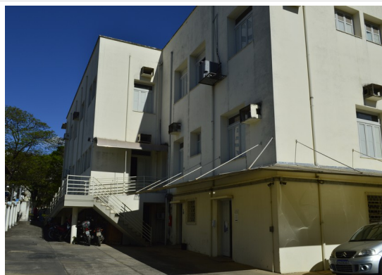
Pará de Minas Fórum Desembargador Pedro Nestor Fachada lateral direita da edificação. (foto 03) Imagem: Júllia Gomes – 01/09/2021
