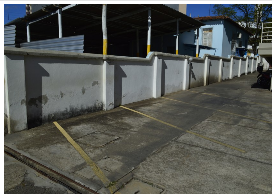
Pará de Minas Fórum Desembargador Pedro Nestor Camada asfáltica do estacionamento com remendos. (foto 30) Imagem: Júlia Gomes – 01/09/2021
