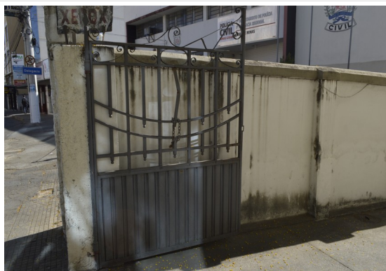
Pará de Minas Fórum Desembargador Pedro Nestor Portão em ferro na lateral esquerda da edificação apresenta barra amassada. (foto 17) Imagem: Júllia Gomes – 01/09/2021
