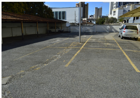
Pará de Minas Fórum Desembargador Pedro Nestor Piso cimentado no estacionamento do Fórum. (foto 29) Imagem: Júlia Gomes – 01/09/2021
