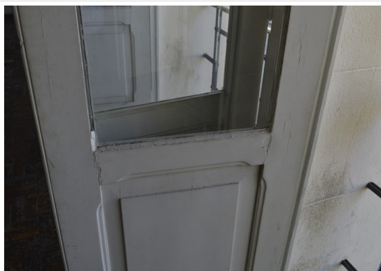
Pará de Minas Fórum Desembargador Pedro Nestor Deterioração da massa no vidro de fechamento das janelas do 1º pavimento. (foto 19) Imagem: Júllia Gomes – 01/09/2021
