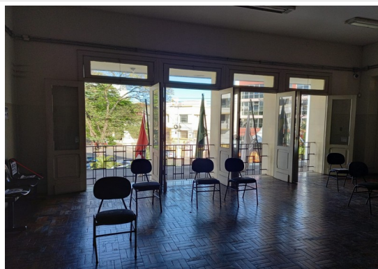
Pará de Minas Fórum Desembargador Pedro Nestor Janelas rasgadas no 1º pavimento. (foto 18) Imagem: Júllia Gomes – 01/09/2021
