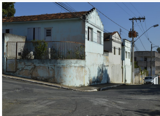
Pará de Minas Gruta de Nossa Senhora de Lourdes Edificação na Via Praça Francisco Valadares necessitando de renovação na camada pictórica. (foto 53) Imagem: Júllia Gomes – 10/11/2021
