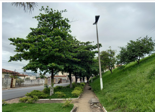
Pará de Minas Gruta de Nossa Senhora de Lourdes Poste em metal apresentando bom estado de conservação. (foto 25) Imagem: Júllia Gomes – 10/11/2021
