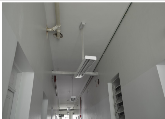
Pará de Minas Irmandade Nossa Senhora da Conceição – Hospital Instalações elétricas. (foto 50) Imagem: Júllia Gomes – 14/10/2021
