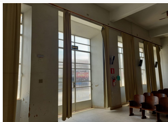
Pará de Minas Irmandade Nossa Senhora da Conceição – Hospital Vista interna da porta e janelas da fachada frontal. (foto 22) Imagem: Júllia Gomes – 14/10/2021
