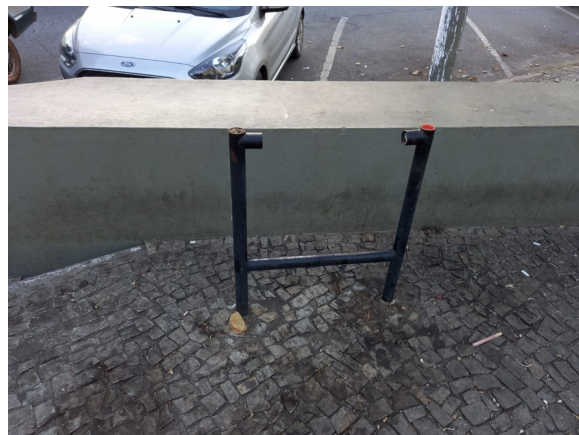
Pará de Minas Praças Torquato de Almeida e Francisco Torquato Estrutura que compõe a lixeira sem o cesto. (foto 21) Imagem: Júllia Gomes– 16/07/2021
