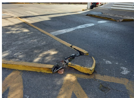
Pará de Minas Praças Torquato de Almeida e Francisco Torquato Parte da calçada exibindo rompimento (foto 07) Imagem: Júllia Gomes – 15/07/2021
