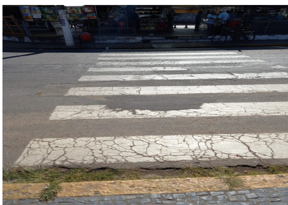
Pará de Minas Praças Torquato de Almeida e Francisco Torquato Asfalto apresentando algumas trincas naturais em expansão devido ao impacto constante e desgaste pictórico na sinalização horizontal (foto 06) Imagem: Júllia Gomes – 15/07/2021
