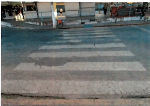
Pará de Minas Praças Torquato de Almeida e Francisco Torquato Asfalto apresentando algumas trincas naturais em expansão devido ao impacto constante e desgaste pictórico na sinalização horizontal (foto 06) Imagem: Laís Costa – 29/07/2022
