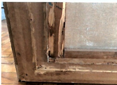
Pará de Minas Telas da Antiga Matriz de Nossa Senhora da Piedade Chassi sob ataque de insetos xilófagos, especialmente em suas porções inferiores. (foto 35) Imagem: Laís Costa – 05/11/2022
