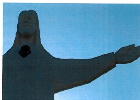
Pará de Minas Cristo Redentor Braço esquerdo do Cristo Redentor apresenta bom estado do reboco e pintura. (foto 10) Imagem: Laís Costa – 08/07/2022
