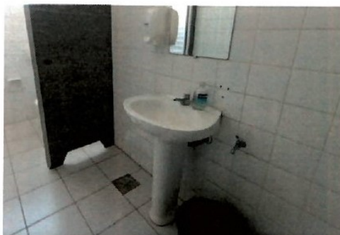
Pará de Minas Fórum Desembargador Pedro Nestor Cerâmica comum aos banheiros. (foto 13) Imagem: Gabriela Conceição – 02/01/2023
