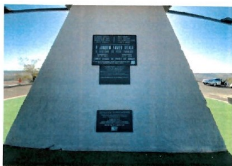
Pará de Minas Cristo Redentor Frente do pedestal e da base, exibindo bom estado em nova camada pictórica. (foto 11) Imagem: Laís Costa – 08/07/2022
