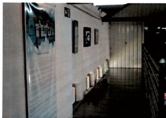
Pará de Minas Estação Ferroviária Reboco e pintura internos exibem ótimo estado. (foto 17) Imagem: Laís Costa – 21/07/2022
