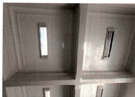
Pará de Minas Fórum Desembargador Pedro Nestor Pintura à base de água no forro do pavimento térreo. (foto 12) Imagem: Gabriela Conceição – 02/01/2023
