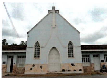
Pará de Minas Asilo Padre José Pereira Coelho Pintura da fachada frontal necessitando de renovação. (foto 14) Imagem: Lais Costa – 02/11/2022
