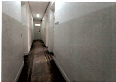
Pará de Minas Fórum Desembargador Pedro Nestor Reboco interno e camada pictórica à base de água e barrado a óleo. (foto 11) Imagem: Gabriela Conceição – 02/01/2023
