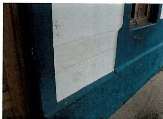
Pará de Minas Estação Ferroviária Detalhe das sujidades na fachada frontal. (foto 16) Imagem: Laís Costa – 21/07/2022
