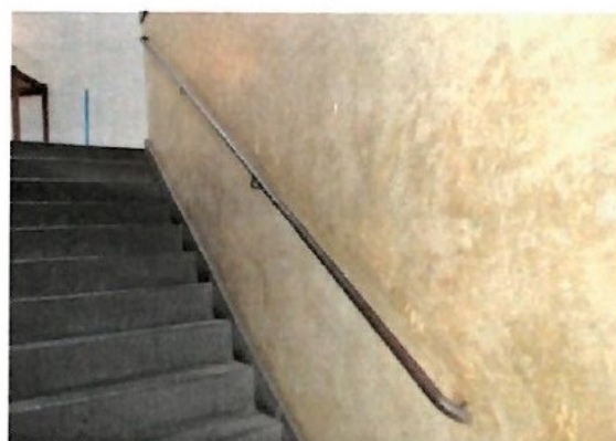
Pará de Minas Estação Ferroviária Parede com textura de cimento queimado junto à escada de acesso ao mezanino exibe alguns riscos e manchas. (foto 18) Imagem: Laís Costa – 21/07/2022
