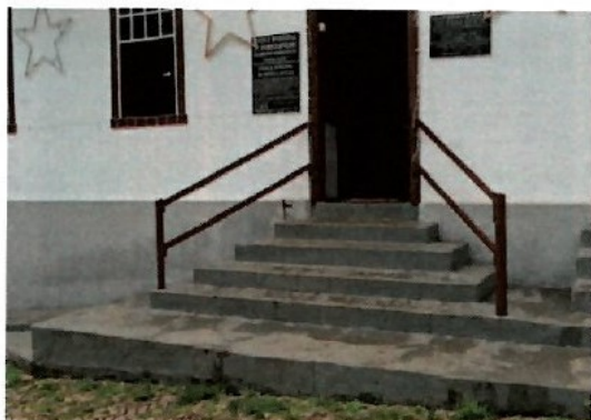
Pará de Minas Escola Municipal de Artes e Ofícios Raimundo Nogueira de Faria - SICA A escadaria do acesso principal. (foto 44) Imagem: Laís Costa – 19/08/2022
