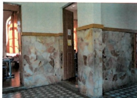
Pará de Minas Escola Estadual Torquato de Almeida Pedras Ouro Preto revestindo todo o barrado da circulação. (foto 14) Imagem: Laís Costa – 18/08/2022
