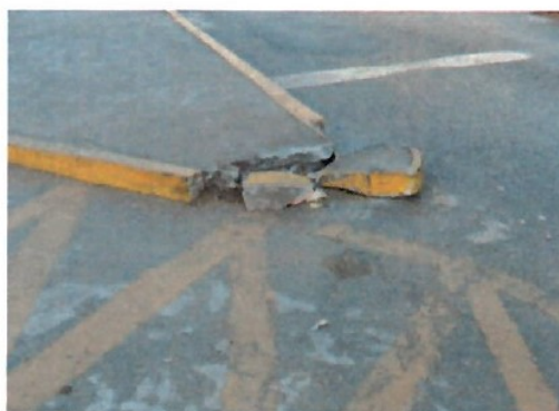
Pará de Minas Praças Torquato de Almeida e Francisco Torquato Parte da calçada exibindo rompimento (foto 07) Imagem: Laís Costa – 29/07/2022
