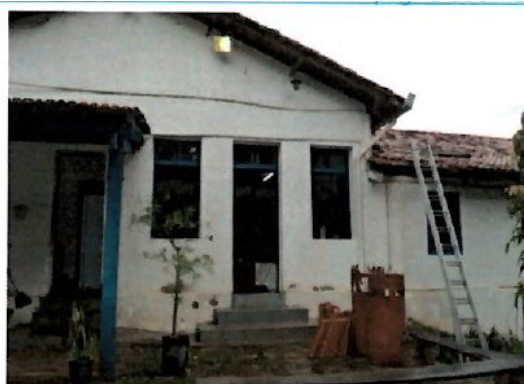
Pará de Minas Escola Municipal de Artes e Ofícios Raimundo Nogueira de Faria - SICA Escada de acesso à varanda e ao quintal. (foto 43) Imagem: Laís Costa – 19/08/2022
