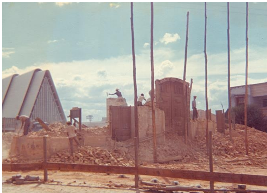
Demolição da antiga Matriz e Construção da Nova, hoje Santuário Nossa Senhora da Piedade – 1971 Arquivo Muspam
