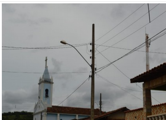
Pará de Minas Gruta de Nossa Senhora de Lourdes Fiação aparente na Rua Nossa Senhora da Piedade. (foto 36) Imagem: Laís Costa – 23/11/2022
