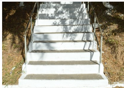
Pará de Minas Gruta de Nossa Senhora de Lourdes Escadaria que conecta a Rua Fernando Otávio com a via Praça Francisco Valadares exibe nova camada pictórica porém apresenta desgaste na pintura do guarda-corpo. (foto 20) Imagem: Laís Costa – 15/07/2022
