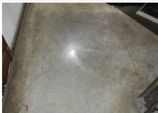
Pará de Minas Estação Ferroviária Piso em cimento queimado no salão principal finalizado na obra de 2019 em ótimo estado de conservação e limpeza. (foto 44) Imagem: Laís Costa – 21/07/2022
