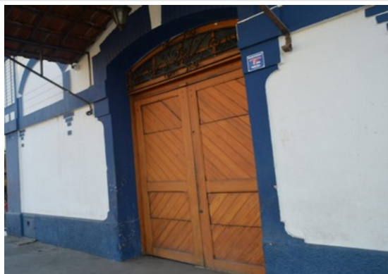
Pará de Minas Estação Ferroviária Porta de madeira ao lado esquerdo na fachada frontal exhibe recortes nas folhas executados anteriormente a retomada do bem pelo município. (foto 27) Imagem: Laís Costa – 21/07/2022
