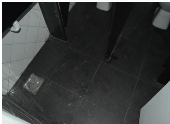
Pará de Minas Estação Ferroviária Piso em granito dos banheiros do mezanino. (foto 47) Imagem: Laís Costa – 21/07/2022
