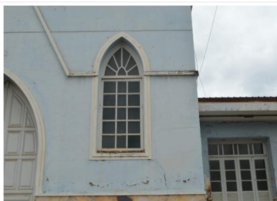
Pará de Minas Asilo Padre José Pereira Coelho Janela da fachada frontal em metal e vidro e enquadramento em massa bem conservadas, nota-se manchas de intempéries no peitoril. (foto 27) Imagem: Laís Costa– 02/11/2022
