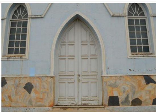
Pará de Minas Asilo Padre José Pereira Coelho Porta em madeira de acesso à Capela, exibindo leve desgaste na base. (foto 20) Imagem: Laís Costa– 02/11/2022
