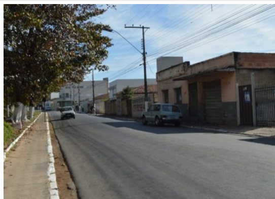
Pará de Minas Gruta de Nossa Senhora de Lourdes Sarjeta na Rua Fernando Otávio em bom estado de conservação. (foto 09) Imagem: Laís Costa – 15/07/2022
