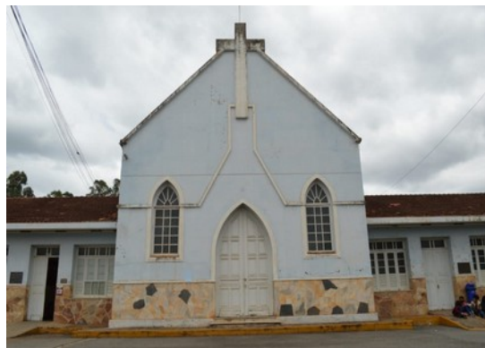
Pará de Minas Asilo Padre José Pereira Coelho Pintura da fachada frontal necessitando de renovação. (foto 14) Imagem: Laís Costa – 02/11/2022
