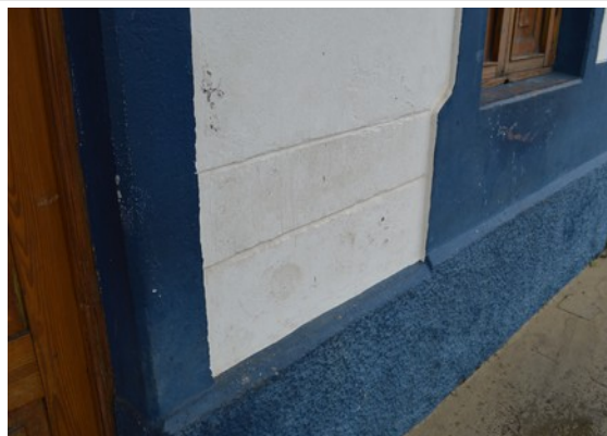
Pará de Minas Estação Ferroviária Detalhe das sujidades na fachada frontal. (foto 16) Imagem: Laís Costa – 21/07/2022
