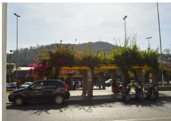
Pará de Minas Praças Torquato de Almeida e Francisco Torquato Caramanchão retangular em concreto pré-moldado em bom estado com vegetação (foto 24) Imagem: Laís Costa – 29/07/2022
