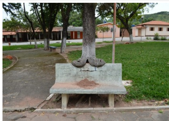
Pará de Minas Núcleo Histórico Urbano do Distrito de Carioca Banco em concreto exibindo algumas trincas devido ao esforço que a árvore está exercendo sobre o concreto. (foto 72) Imagem: Laís Costa – 23/11/2022
