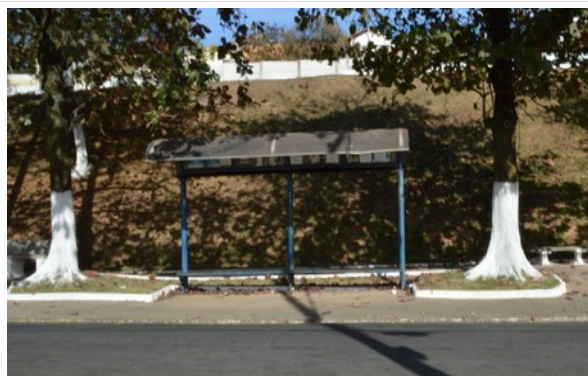
Pará de Minas Gruta de Nossa Senhora de Lourdes Parada de ônibus com abrigo em bom estado de conservação exibindo apenas desgaste da camada pictórica em seu assento. (foto 26) Imagem: Laís Costa – 15/07/2022
