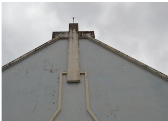
Pará de Minas Asilo Padre José Pereira Coelho Frontão e cimalha simples bem conservados. (foto 08) Imagem: Laís Costa – 02/11/2022
