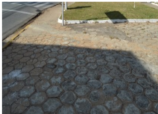
Pará de Minas Gruta de Nossa Senhora de Lourdes Piso de concreto intertravado apresenta algumas fissuras e pequenos desníveis devido a compactação irregular do terreno. (foto 18) Imagem: Laís Costa – 15/07/2022
