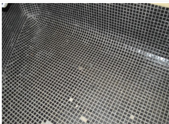
Pará de Minas Estação Ferroviária Pastilhas do banheiro PNE exibindo perda de algumas peças. (foto 46) Imagem: Laís Costa – 21/07/2022
