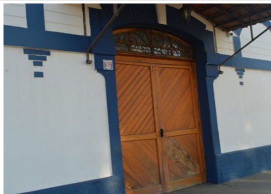
Pará de Minas Estação Ferroviária Porta de madeira ao lado direito na fachada frontal exhibe desgaste do material. (foto 28) Imagem: Laís Costa – 21/07/2022
