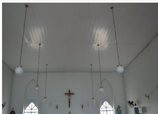
Pará de Minas Asilo Padre José Pereira Coelho Forro de PVC da Capela de Santo Antônio (foto 47) Imagem: Laís Costa– 02/11/2022
