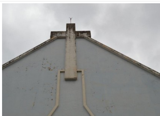
Pará de Minas Asilo Padre José Pereira Coelho Proteção contra descargas elétricas. (foto 59) Imagem: Laís Costa– 02/11/2022
