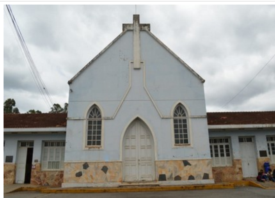
Pará de Minas Asilo Padre José Pereira Coelho Alvenarias externas da capela apresentam boa conservação. (foto 10) Imagem: Laís Costa– 02/11/2022
