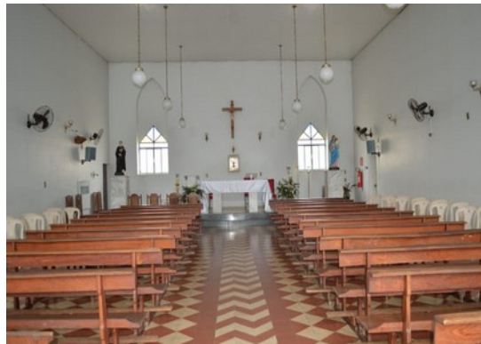
Pará de Minas Asilo Padre José Pereira Coelho Reboco e pinturas à base de água do interior da Capela em bom estado de conservação. (foto 12) Imagem: Laís Costa– 02/11/2022
