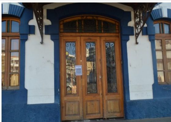
Pará de Minas Estação Ferroviária Porta de acesso principal exibindo algum desgaste na madeira porém no geral aparenta bom estado de conservação. (foto 25) Imagem: Laís Costa – 21/07/2022
