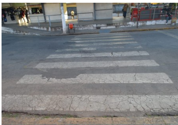
Pará de Minas Praças Torquato de Almeida e Francisco Torquato Asfalto apresentando algumas trincas naturais em expansão devido ao impacto constante e desgaste pictórico na sinalização horizontal (foto 06) Imagem: Laís Costa – 29/07/2022
