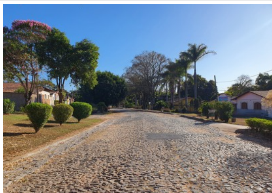
Pará de Minas Núcleo Histórico Urbano do Distrito de Ascensão Rua Raimundo Penaforte de Araújo exibindo remendos asfálticos. (foto 06) Imagem: Laís Costa – 26/07/2022
