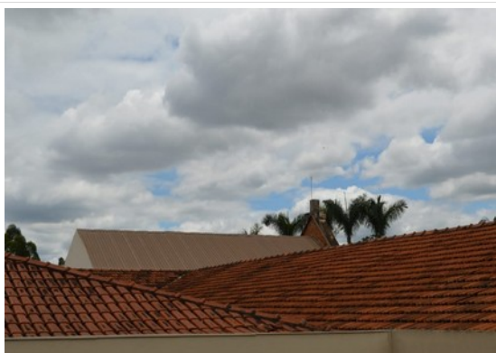
Pará de Minas Asilo Padre José Pereira Coelho O manto de cobertura necessita de intervenção para solucionar infiltrações. (foto 06) Imagem: Laís Costa – 02/11/2022
