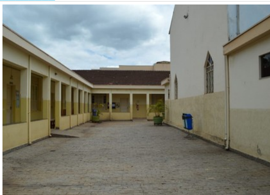
Pará de Minas Asilo Padre José Pereira Coelho A estrutura em vigas e pilares de concreto armado não apresenta danos. (foto 05) Imagem: Laís Costa – 02/11/2022
