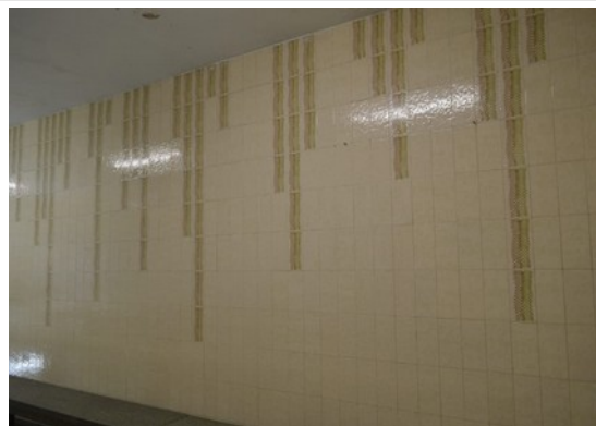
Pará de Minas Escola Estadual Torquato de Almeida Cerâmicas que revestem as paredes do refeitório. (foto 17) Imagem: Laís Costa – 18/08/2022
