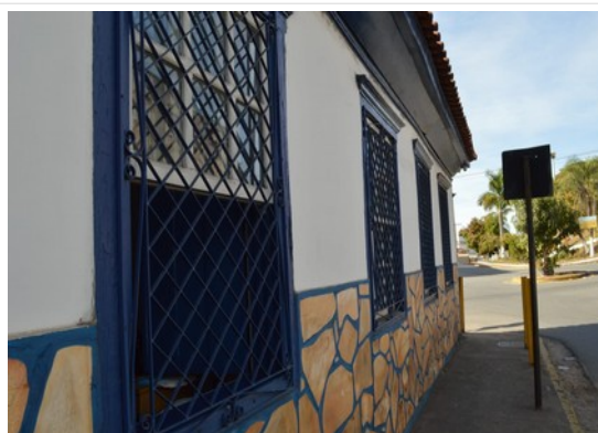
Pará de Minas Casa Maria Capanema Janelas tipo guilhotina em madeira e vidro e grade em metal com camada pictórica em bom estado. (foto 27) Imagem: Laís Costa – 15/07/2022
