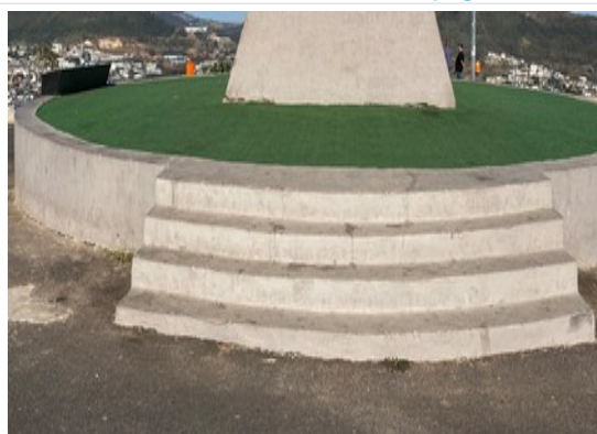
Pará de Minas Cristo Redentor A escada não apresenta danos na sua estrutura, mas exhibe sujidades. (foto 14) Imagem: Laís Costa – 08/07/2022
