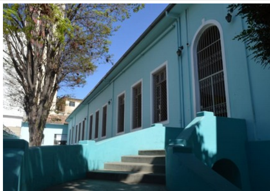
Pará de Minas Escola Estadual Torquato de Almeida Fachada lateral direita. (foto 02) Imagem: Laís Costa – 18/08/2022
