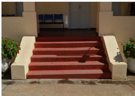
Pará de Minas Escola Estadual Governador Valadares Escada que dá acesso ao pátio. (foto 40) Imagem: Laís Costa– 26/08/2022
