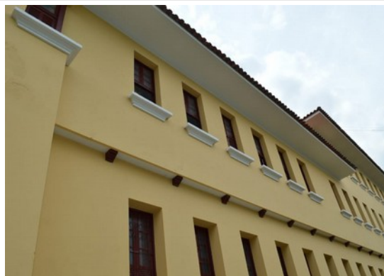
Pará de Minas Escola Estadual Fernando Otávio Beirais da fachada frontal. (foto 10) Imagem: Laís Costa – 09/11/2022
