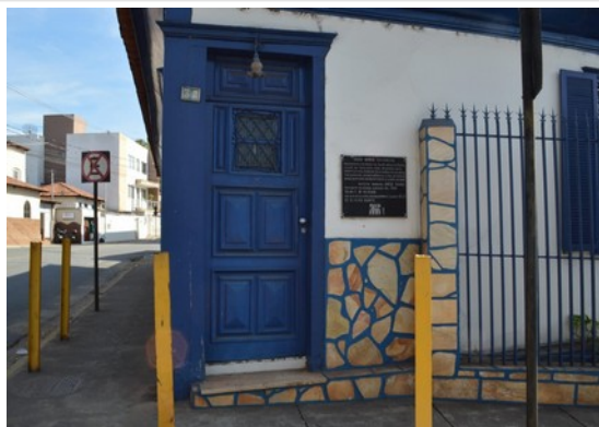
Pará de Minas Casa Maria Capanema Porta em madeira na fachada frontal exibindo bom estado de conservação. (foto 22) Imagem: Laís Costa – 15/07/2022
