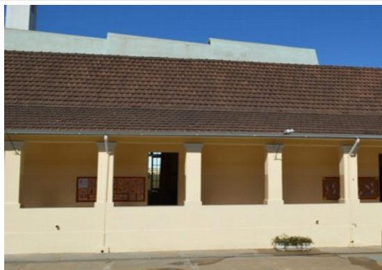
Pará de Minas Escola Estadual Governador Valadares Telhas francesas em bom estado de conservação exibindo apenas manchas de umidade. (foto 08) Imagem: Laís Costa– 26/08/2022
