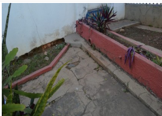
Pará de Minas Casa Maria Capanema Piso cimentado exhibe trincas e manchas e algumas partes perca de material, causadas pela exposição à umidade. (foto 35) Imagem: Laís Costa – 15/07/2022
