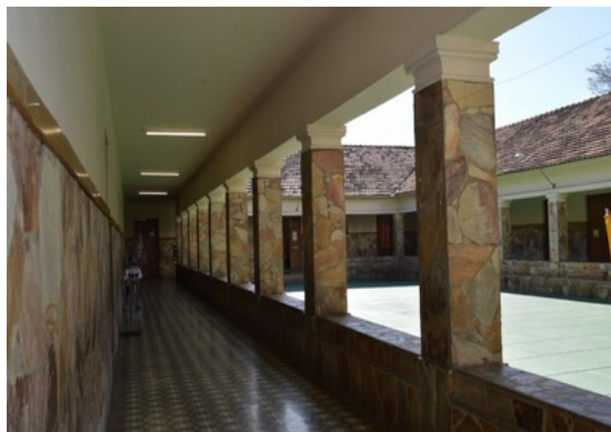
Pará de Minas Escola Estadual Torquato de Almeida Pintura a base de água nas alvenarias e na laje. (foto 13) Imagem: Laís Costa – 18/08/2022
