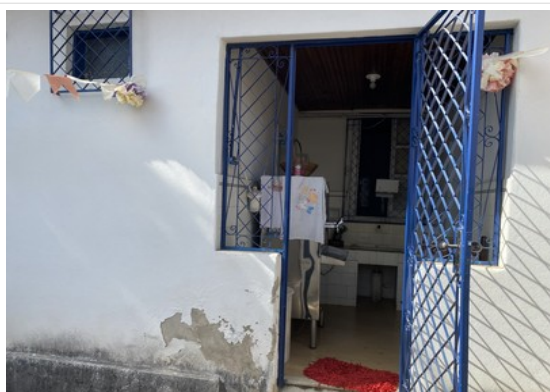
Pará de Minas Casa Maria Capanema Ferragens sem fechamentos em bom estado de conservação na fachada posterior do bem. (foto 26) Imagem: Laís Costa – 15/07/2022
