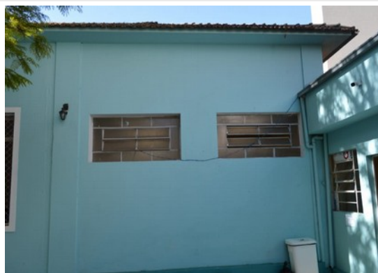
Pará de Minas Escola Estadual Torquato de Almeida Janelas em metal e vidro e enquadramento em massa nos banheiros na lateral esquerda do bem. (foto 23) Imagem: Laís Costa – 18/08/2022
