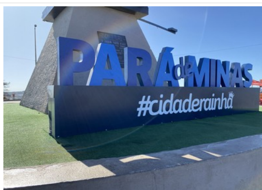
Pará de Minas Cristo Redentor Instalação de letreiro turístico na base frontal à estrutura. (foto 16) Imagem: Laís Costa – 08/07/2022
