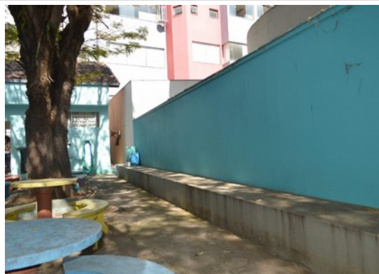
Pará de Minas Escola Estadual Torquato de Almeida Muro lateral direito da edificação. (foto 38) Imagem: Laís Costa – 18/08/2022
