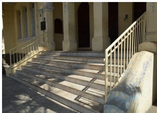
Pará de Minas Escola Estadual Governador Valadares Escada do acesso principal revestida por mármore. (foto 17) Imagem: Laís Costa– 26/08/2022
