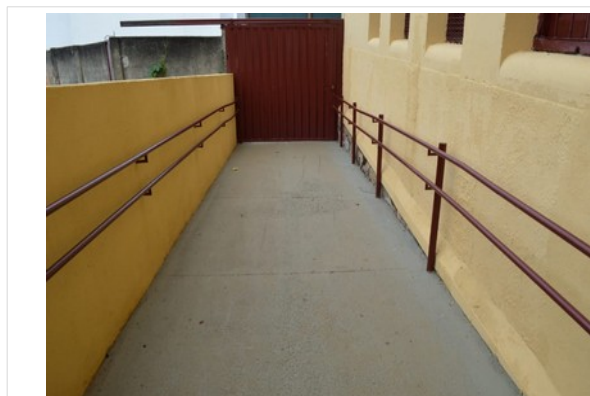
Pará de Minas Escola Estadual Fernando Otávio Rampa de acesso lateral em cimento. (foto 35) Imagem: Laís Costa – 09/11/2022
