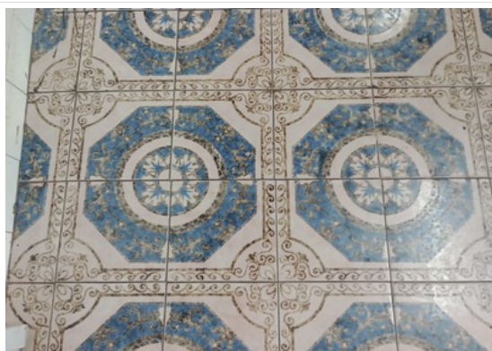
Pará de Minas Casa Maria Capanema Cerâmica comum a copa, cozinha e banheiro com algumas fissuras. (foto 37) Imagem: Laís Costa – 15/07/2022
