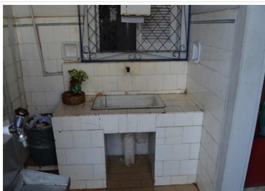
Pará de Minas Casa Maria Capanema Cerâmicas apresentando algumas fissuras e desgaste nos rejuntas. (foto 21) Imagem: Laís Costa – 15/07/2022
