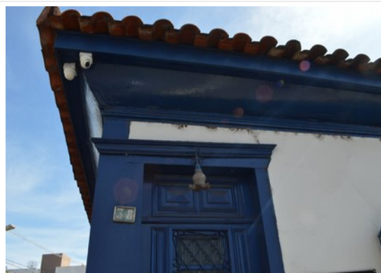
Pará de Minas Casa Maria Capanema Cimalhas apresentando bom estado de conservação. (foto 10) Imagem: Laís Costa – 15/07/2022
