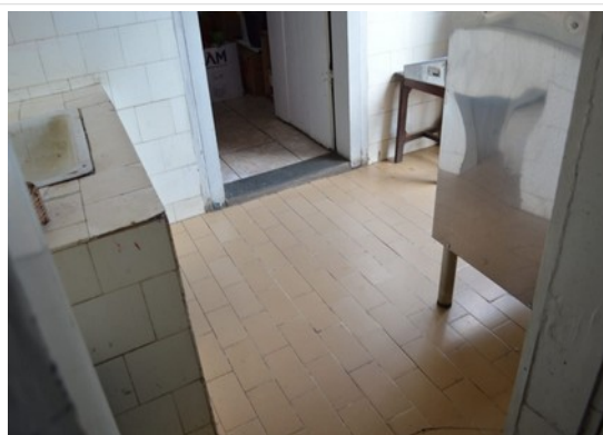
Pará de Minas Casa Maria Capanema Cerâmica em pequeno hall que dá acesso ao quintal nos fundos apresenta trinca e rejunte desgastado. (foto 36) Imagem: Laís Costa – 15/07/2022
