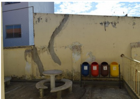
Pará de Minas Escola Estadual Governador Valadares Muro lateral direito exibindo trinca restaurada decorrente de abalo provocado pela construção vizinha. (foto 44) Imagem: Laís Costa– 26/08/2022
