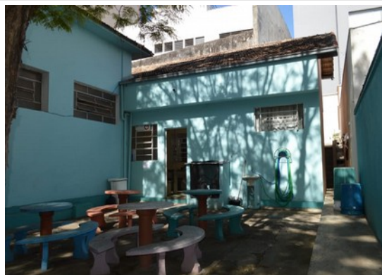
Pará de Minas Escola Estadual Torquato de Almeida Janelas em metal e vidro e enquadramento em massa na cozinha. (foto 21) Imagem: Laís Costa – 18/08/2022
