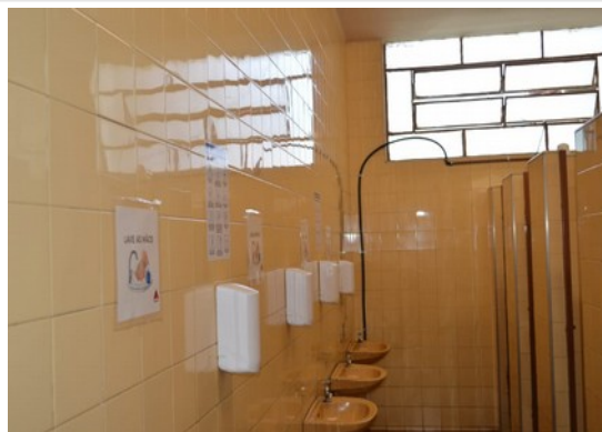
Pará de Minas Escola Estadual Torquato de Almeida Cerâmicas comuns aos banheiros. (foto 16) Imagem: Laís Costa – 18/08/2022
