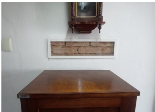
Pará de Minas MUSPAM Detalhe da alvenaria original exposta em moldura com fechamento em vidro no interior do MUSPAM. (foto 13) Imagem: Gabriela Conceição – 11/10/2022
