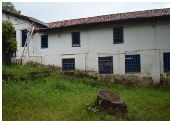
Pará de Minas Escola Municipal de Artes e Ofícios Raimundo Nogueira de Faria - SICA Alvenaria externa, fachada posterior, com limo na base. (foto 13) Imagem: Laís Costa – 19/08/2022
