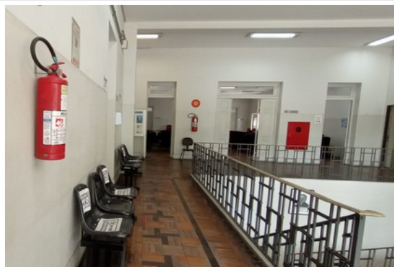
Pará de Minas Fórum Desembargador Pedro Nestor Vista interna observando viga e pilar. (foto 06) Imagem: Gabriela Conceição – 02/01/2023
