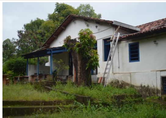
Pará de Minas Escola Municipal de Artes e Ofícios Raimundo Nogueira de Faria - SICA Vista do quintal para os fundos do bem. (foto 47) Imagem: Laís Costa – 19/08/2022
