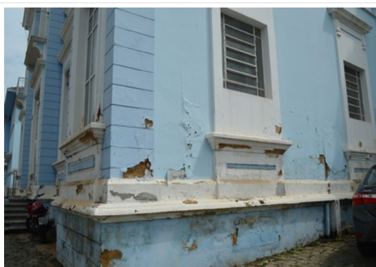
Pará de Minas Irmandade Nossa Senhora da Conceição – Hospital Pintura exibe perca de material na lateral do edifício. (foto 15)
