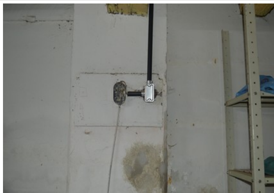
Pará de Minas Escola Municipal de Artes e Ofícios Raimundo Nogueira de Faria - SICA Instalações elétricas. (foto 51) Imagem: Laís Costa – 19/08/2022
