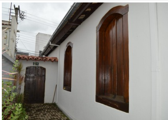
Pará de Minas MUSPAM Janela em madeira e enquadramento apresentando bom estado de conservação. (foto 22) Imagem: Laís Costa – 11/10/2022
