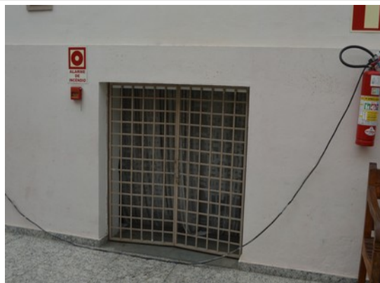
Pará de Minas Prédio Juscelino Kubitschek de Oliveira – Casa da Cultura Portão de grade metálica de acesso ao porão. (foto 20) Imagem: Laís Costa – 22/07/2022
