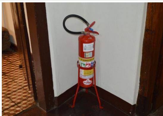
Pará de Minas MUSPAM Instalações de prevenção e combate a incêndio segundo normas do Corpo de Bombeiros. (foto 51) Imagem: Laís Costa – 11/10/2022
