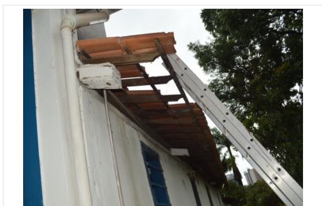
Pará de Minas Escola Municipal de Artes e Ofícios Raimundo Nogueira de Faria - SICA Coletor de águas pluviais. (foto 11) Imagem: Laís Costa – 19/08/2022
