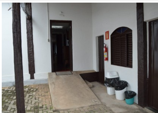
Pará de Minas MUSPAM Varanda nos fundos da edificação e seus elementos construtivos apresentam bom estado de conservação. (foto 42) Imagem: Laís Costa – 11/10/2022
