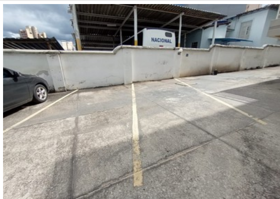
Pará de Minas Fórum Desembargador Pedro Nestor Piso cimentado no estacionamento do Fórum. (foto 29) Imagem: Gabriela Conceição – 02/01/2023
