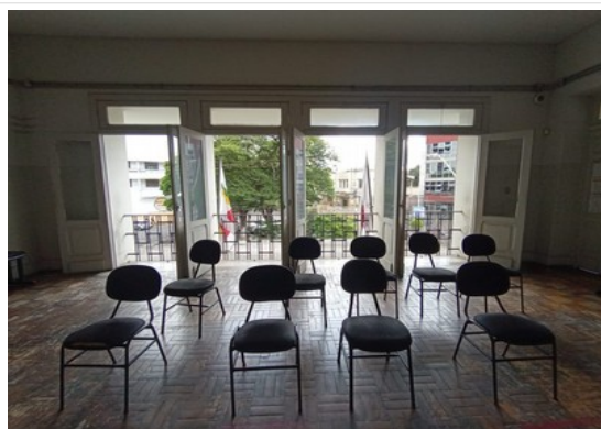
Pará de Minas Fórum Desembargador Pedro Nestor Janelas rasgadas no 1º pavimento. (foto 18)
