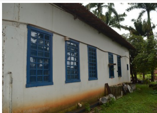
Pará de Minas Escola Municipal de Artes e Ofícios Raimundo Nogueira de Faria - SICA Alvenaria externa da fachada posterior. (foto 08) Imagem: Laís Costa – 19/08/2022
