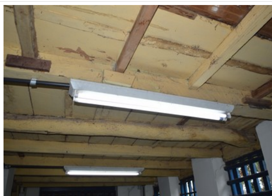
Pará de Minas Escola Municipal de Artes e Ofícios Raimundo Nogueira de Faria - SICA Intervenção paleativa nas frestas do assoalho de madeira. (foto 32) Imagem: Laís Costa – 19/08/2022
