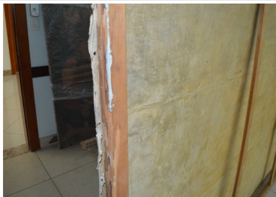
Pará de Minas Telas da Antiga Matriz de Nossa Senhora da Piedade Chassi apresenta severo ataque de insetos xilófagos e a tela desprende-se do mesmo. (foto 27) Imagem: Laís Costa – 05/11/2022
