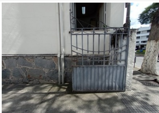
Pará de Minas Fórum Desembargador Pedro Nestor Portão em ferro na lateral esquerda da edificação apresenta barra amassada. (foto 17)
