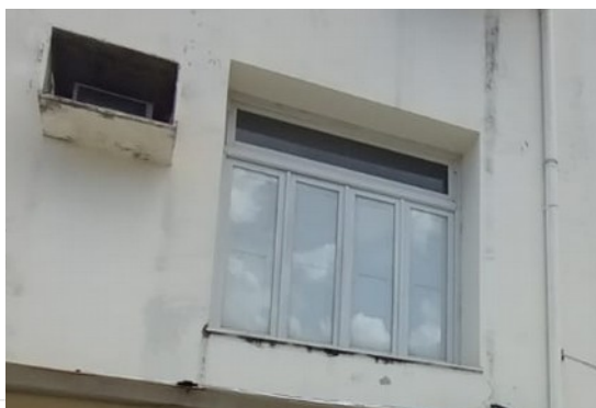
Pará de Minas Fórum Desembargador Pedro Nestor Janela em madeira e enquadramento em massa na fachada
