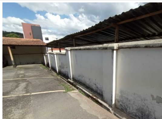
Pará de Minas Fórum Desembargador Pedro Nestor Camada asfáltica do estacionamento com remendos. (foto 30) Imagem: Gabriela Conceição – 02/01/2023
