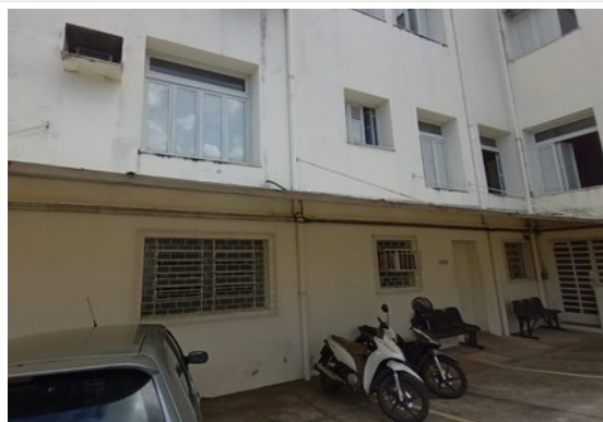
Pará de Minas Fórum Desembargador Pedro Nestor Vista das alvenarias externas, fachada lateral em esquerda. (foto 10) Imagem: Gabriela Conceição – 02/01/2023
