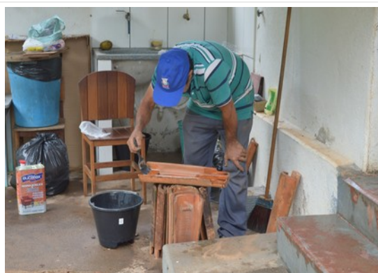
Pará de Minas Escola Municipal de Artes e Ofícios Raimundo Nogueira de Faria - SICA Restauro de telhas em andamento. (foto 16) Imagem: Laís Costa– 19/08/2022
