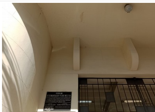
Pará de Minas Fórum Desembargador Pedro Nestor Laje de cobertura da entrada principal apresenta alguns sinais de infiltração. (foto 40) Imagem: Gabriela Conceição – 02/01/2023
