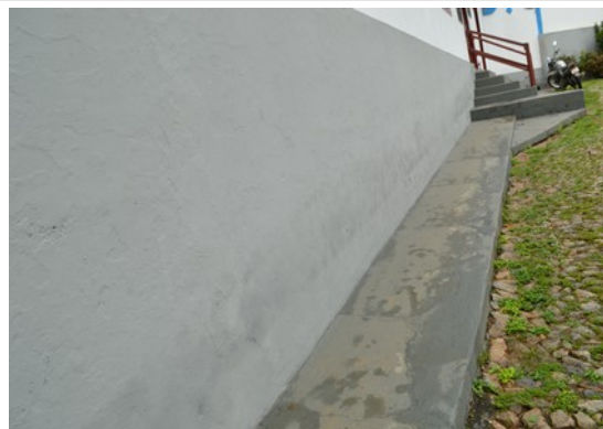
Pará de Minas Escola Municipal de Artes e Ofícios Raimundo Nogueira de Faria - SICA Calçada na fachada frontal do bem. (foto 50) Imagem: Laís Costa – 19/08/2022
