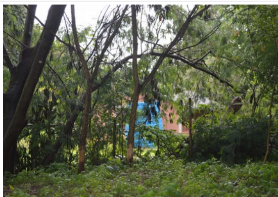
Pará de Minas Escola Municipal de Artes e Ofícios Raimundo Nogueira de Faria - SICA Telas e mourões que dividem o terreno do bem tombado com o IEF cobertos por vegetação. (foto 48) Imagem: Laís Costa – 19/08/2022
