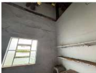
Detalhe da janela e do reboco choco na cozinha
