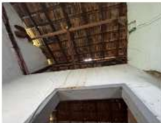
Vista do telhado com telhas quebradas
