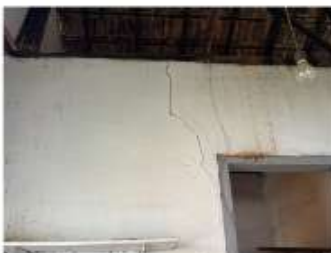
Trincas estruturais que romperam a alvenaria
