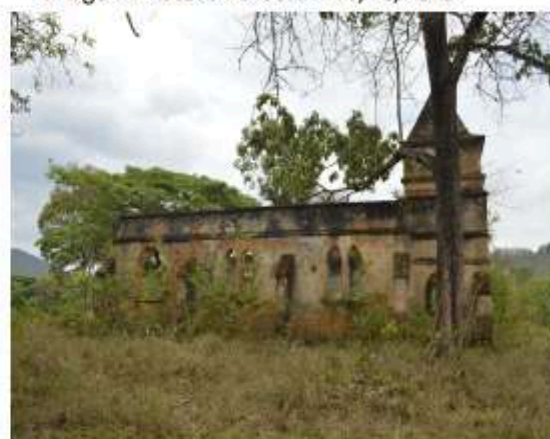
Para de Minas – MG Ruínas da Igreja Povoado dos Guardas Vista do lateral direita, o bem em deterioração. (foto 04)
