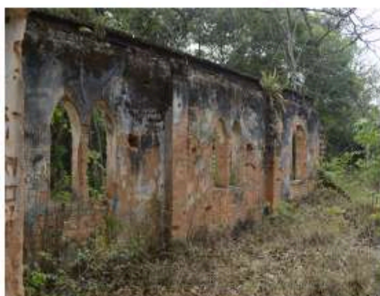
Para de Minas – MG Ruínas da Igreja Povoado dos Guardas Vista da alvenaria com seu reboco deteriorado e expondo o tijolo de barro as intempéries do tempo. (foto 03)
