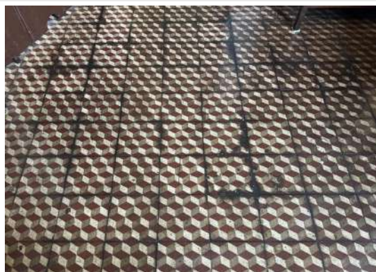
Pará de Minas MUSPAM Ladrilho hidráulico da antiga cozinha exibe manchas escuras nas bordas das peças e nos rejunte. (foto 37) Imagem: Vitória Moraes – 08/08/2025
