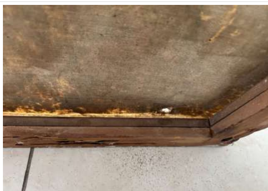
Pará de Minas Detalhe das danificações em um dos antigos chassis. A tela se encontra infestada de insetos xilofagos., causando perda de material. (foto 61) Imagem: Vitória Moraes – 28/11/2025
