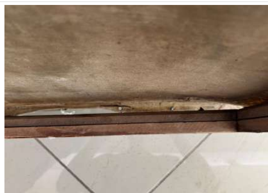
Pará de Minas Desprendimento parcial de uma das telas do chassis, causados pelo retalhamento de tecido e perda de material. (foto 62) Imagem: Vitória Moraes – 28/11/2025
